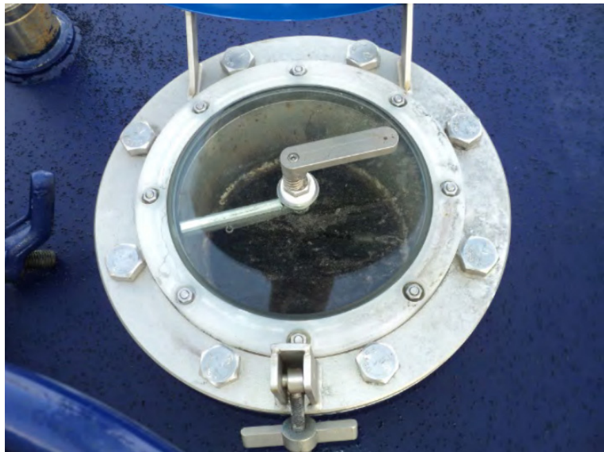
Fig 8: Ponto de inspeção com limpa-vidro
